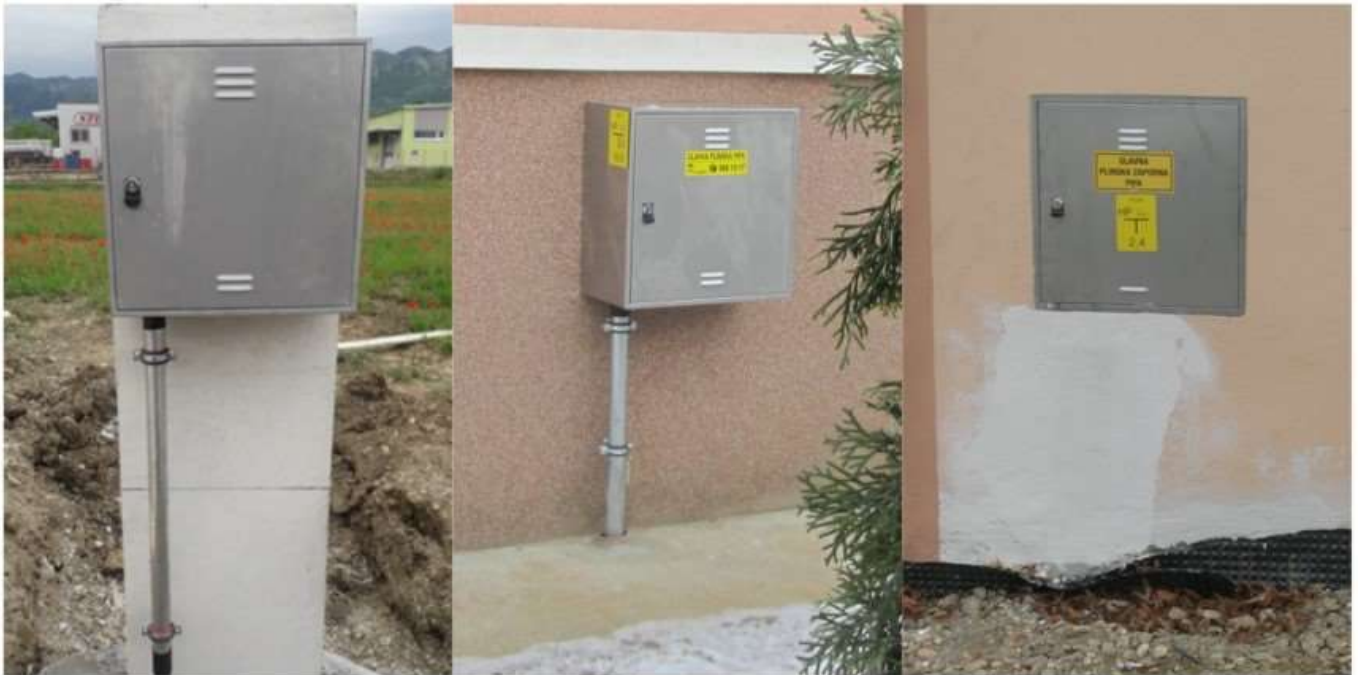
Slika 30: Prikaz plinske omarice na stebričku, na fasadi in v fasadi objekta.
